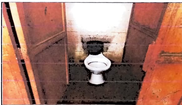
Foto 6: CONDICIÓN DE LOS BAÑOS DEL ESTABLECIMIENTO. SUSTITUCIÓN DE SERVICIOS SANITARIOS Y SUS ACCESORIOS
